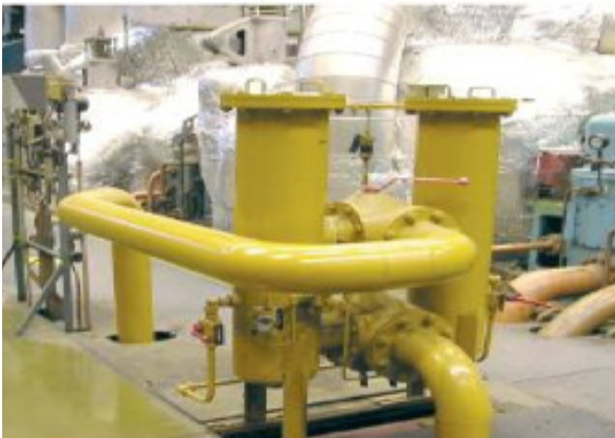
Filtro duplex sistema de lubrificação turbina a vapor
